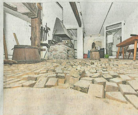
Stolpergefahr in der Bergschmiede: Bevor das Zinnwalder Huthaus genutzt werden kann, müssen die Handwerker ran.
